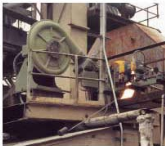
Горелка StarJet с коллектором подготовки мазута.
